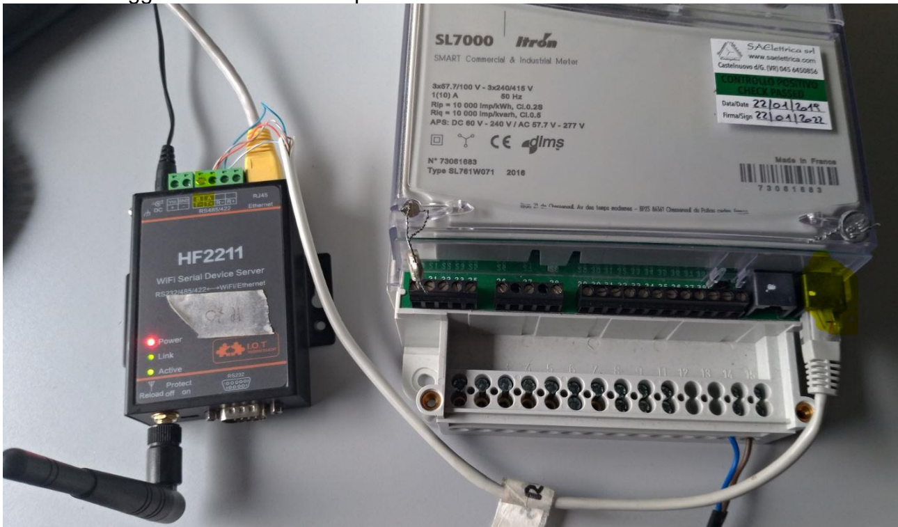
Ecco il cablaggio tra contatore e dispositivo HF2211
